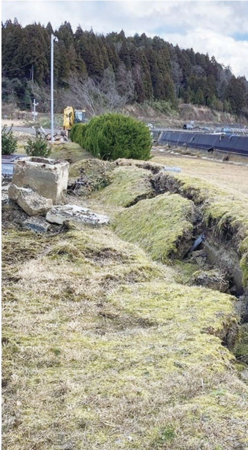
能登半島地震による被害（地盤の隆起） 提供：京都府災害ボランティアセンター
